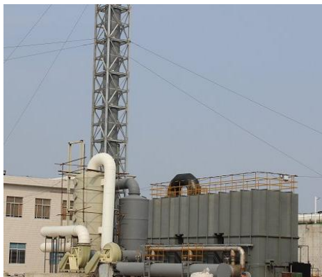
已经投入运营的 RTO 尾气焚烧炉
